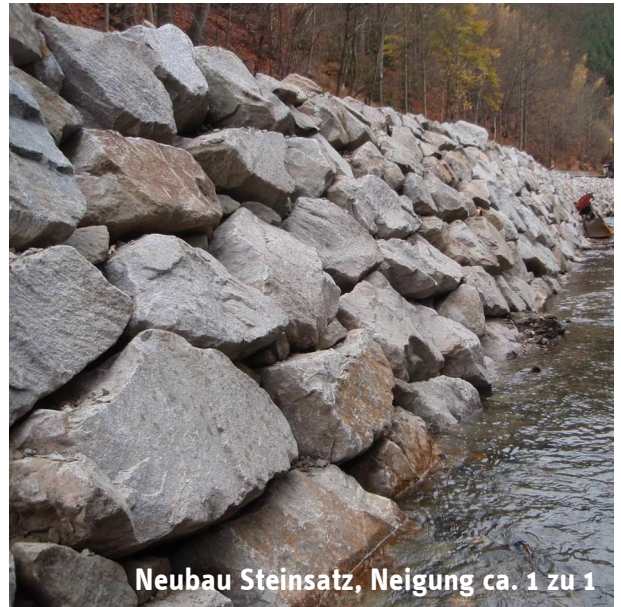
Böschungsrutsch vor Instandsetzung
